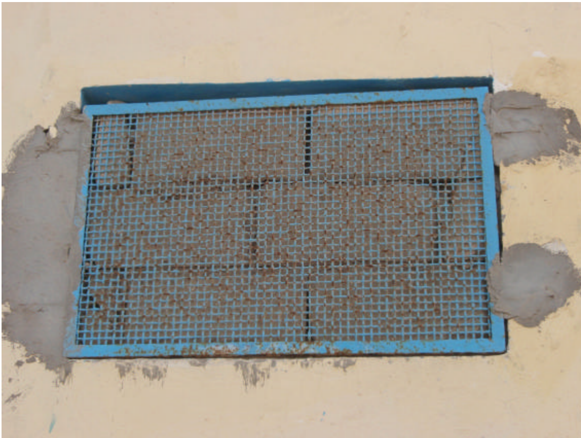
Las ventanas tapiadas y selladas.
